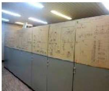
اتاق کنترل واحد شماره ۴
