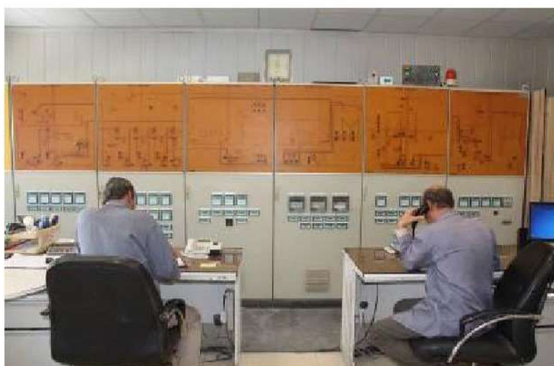
اتاق کنترل واحد شماره یک
