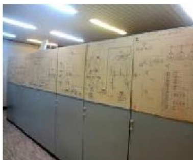
اتاق کنترل واحد شماره ۴
