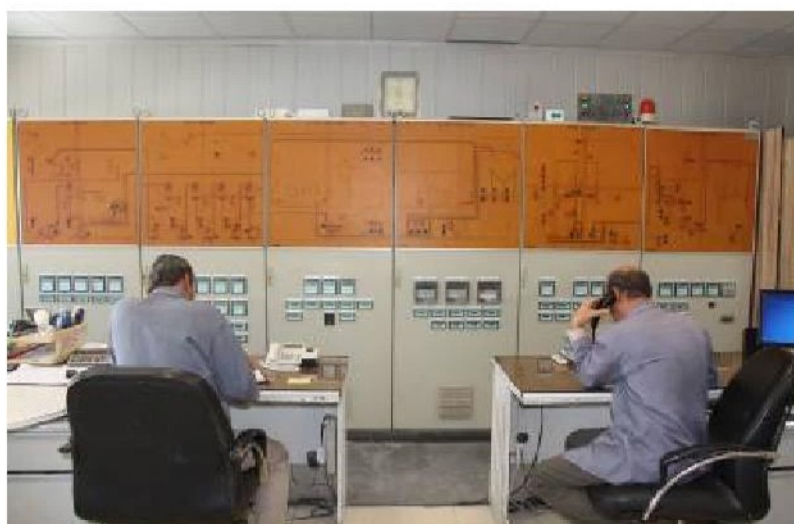
اتاق کنترل واحد شماره یک
